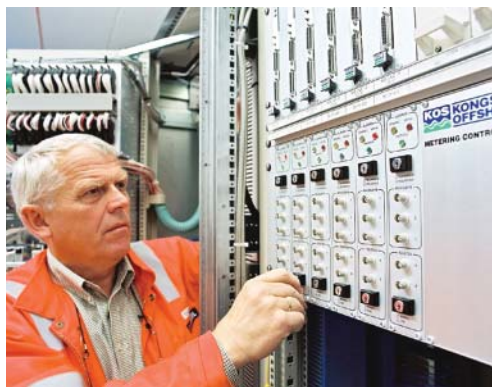
Шесть одноплатных вычислителей расхода FPM 207, установленных в 19-ти дюймовой стойке с двойным источником питания и контрольной панелью внизу.
