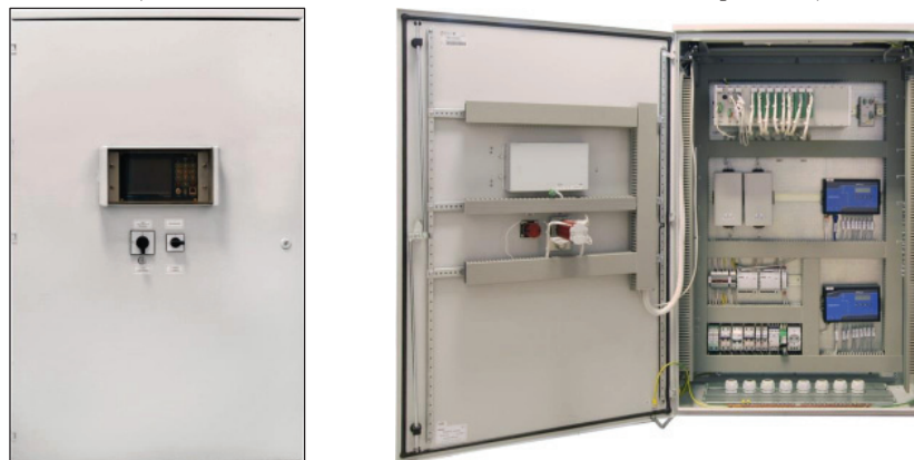
Рисунок 2.7 – Общий вид шкафов 1200*800*400 мм контроллеров ARIS С30х
