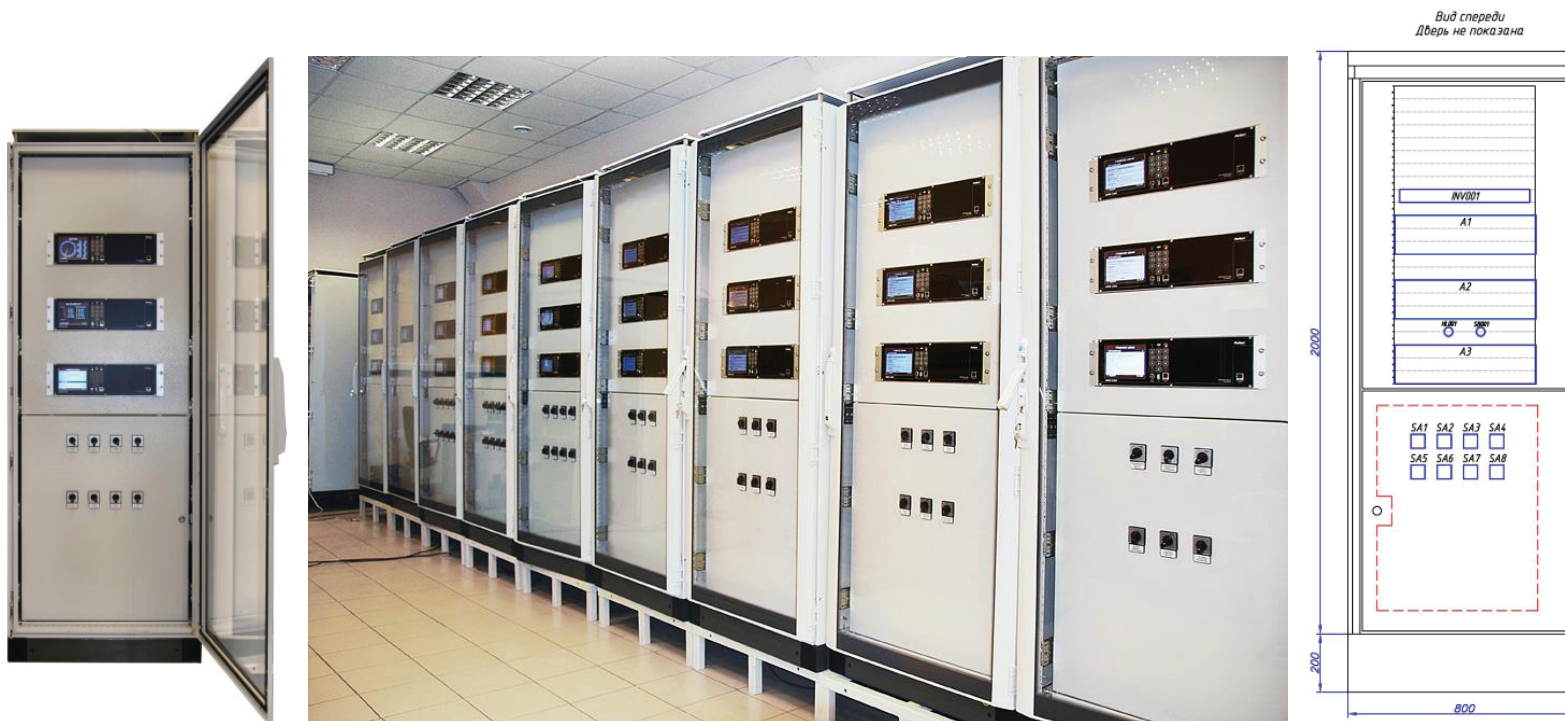
Рисунок 2.1 – Общий вид шкафов 2000*800*800 мм контроллеров ARIS С30х
