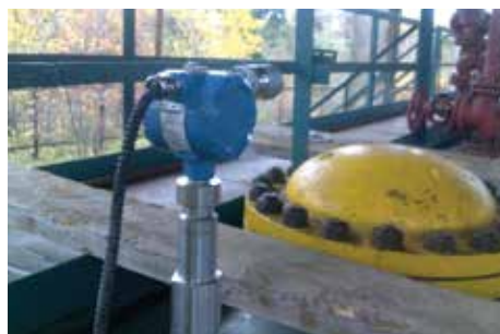
Измерение параметров состояния жидкого аммиака в резервуарах
