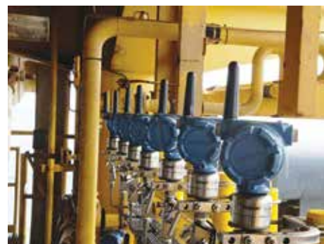
Мониторинг давления в обсадной колонне с Rosemount 3051S
