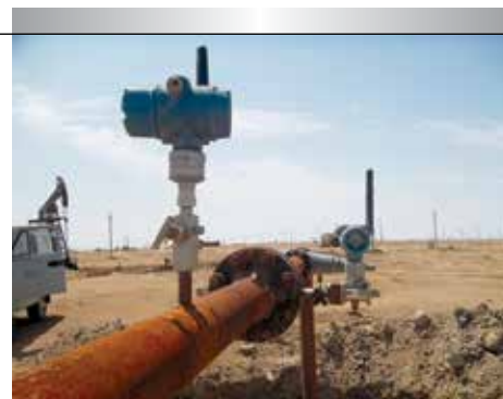
Узлы учета на базе Rosemount 3051S установлены для контроля расхода и давления воды на каждой скважине ППД
