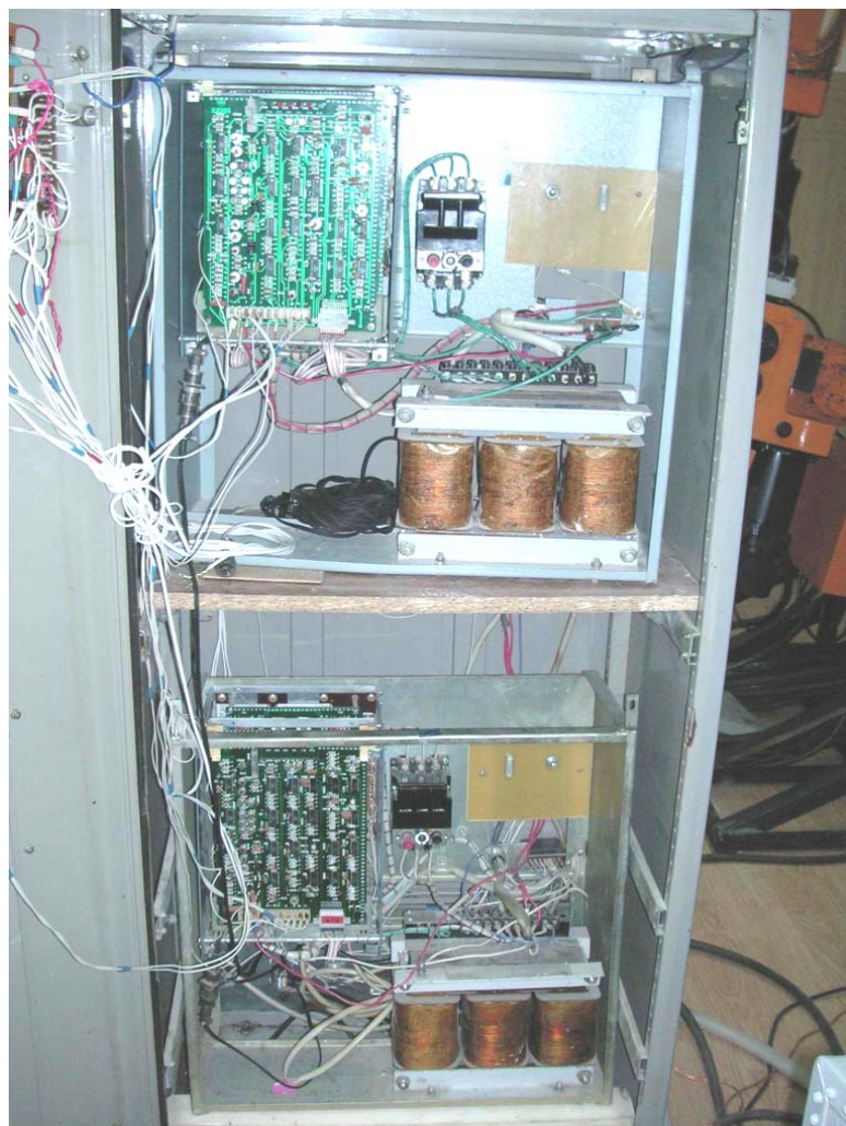
Рис. 2.12. Вид шкафа с электроприводами с открытой дверцей
